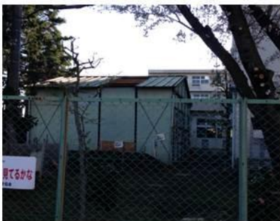
④ 小学校の倉庫の屋根が飛ばされる。
