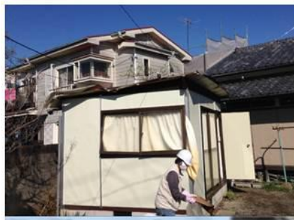
⑤ 屋根が飛ばされ、傾いたプレハブ小屋。
