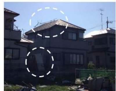
⑥ 倒れたアンテナと傾いた屋外倉庫
