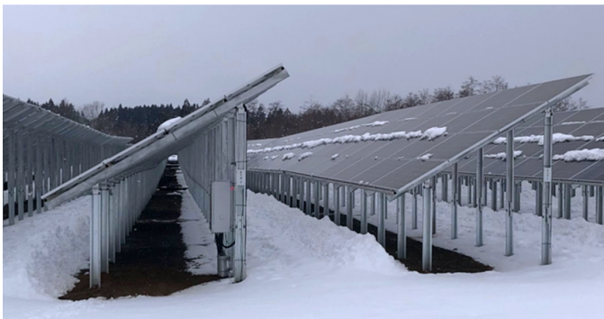
豪雪地帯の太陽光発電所(三井住友トラストグループ提供) 雪が落ちやすい傾斜や高さに設定することで、残雪を回避している
